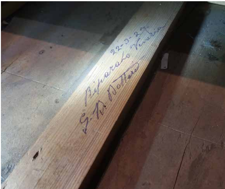
6. Durante il restauro, particolare con iscrizione relativa al restauro del 1927
