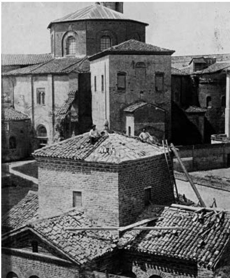
Tetto del mausoleo di Galla Placidia durante i restauri (Soprintendenza Belle Arti e Paesaggio, Archivio fotografico, n. 2408)
