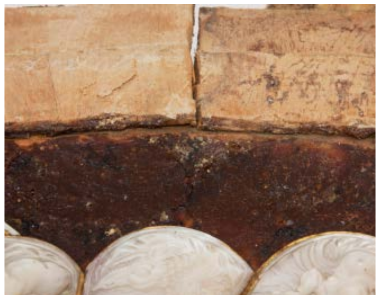
7. Durante il restauro, particolare con i cedimenti della tesa e deformazioni della struttura
