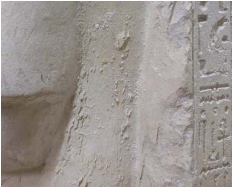
5. Prima del restauro, efflorescenze di cloruri e solfati, la cui cristallizzazione ha determinato esfoliazioni e micro-lesioni superficiali del calcare
